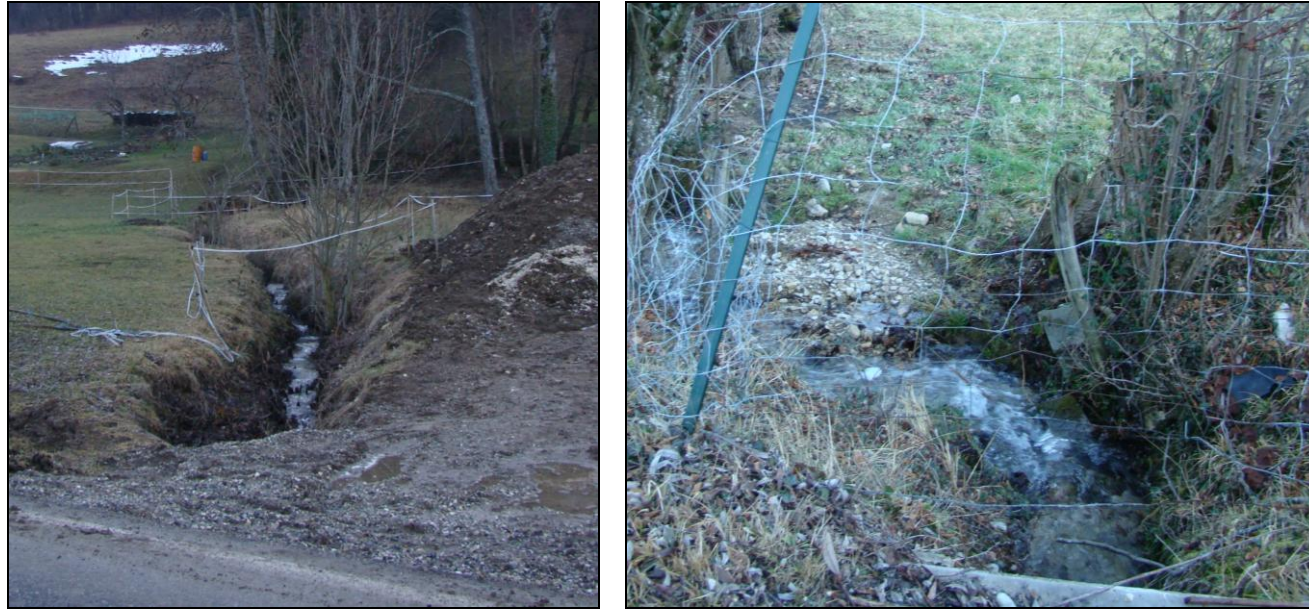
Figure 40 : Torrent affluent en rive gauche du Nant du Vard, aux Mas du Clos (réservoir), busé sous la RD 912 et sous l'habitation en aval [Source : IMSRN]
