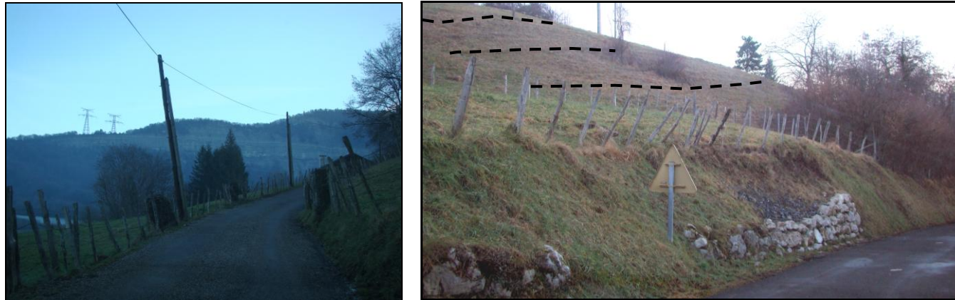
Figure 34 : Poteau incliné, rides de glissement et mur de confortement [Source : IMS RN ]
