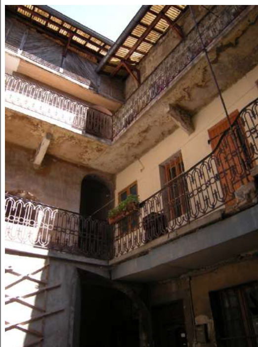
Balcons rue d'Italie. Le balcon inférieur a été dénaturé par un socle en béton.
