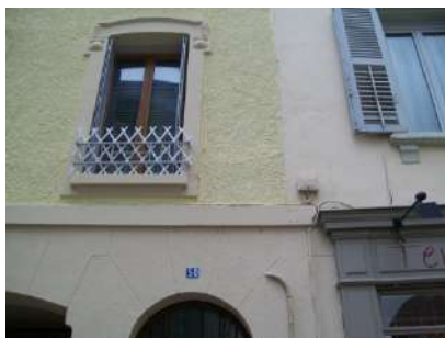
Enduit prêt à l'emploi inadapté !
