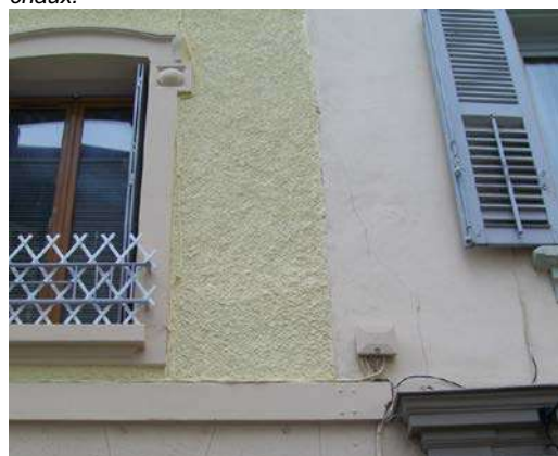
Enduit « rustique » à gauche : cette finition n'est pas admise.
