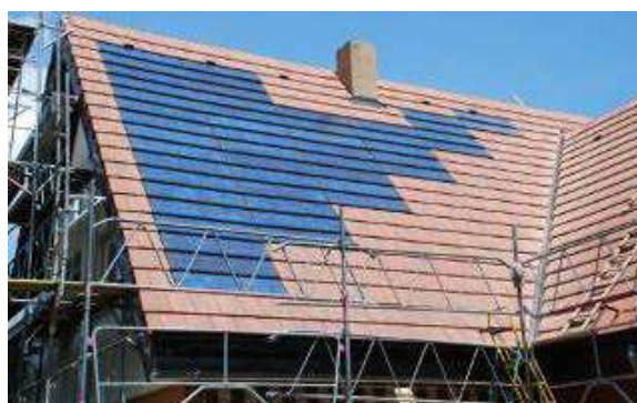
Non respect des ouvertures et des lignes de la toiture ce qui crée un « trou »
