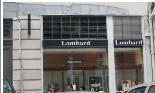
Climatiseurs intégrés dans les vitrines, Grenoble
