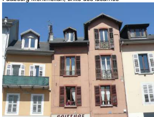
Rue de la République, disparité des lucarnes. Les lucarnes d'origine ont toutes été modifiées, dans des proportions différentes, pour certaines disproportionnées. A éviter.
