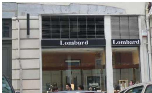
Climatiseurs intégrés dans les vitrines, Grenoble
