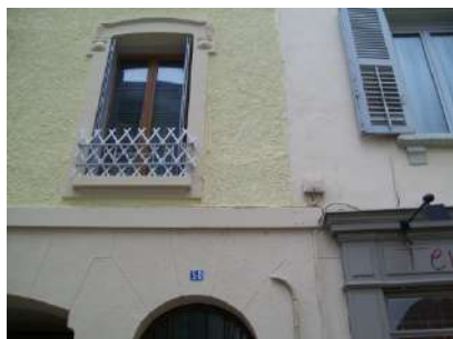
Enduit prêt à l'emploi inadapté !
