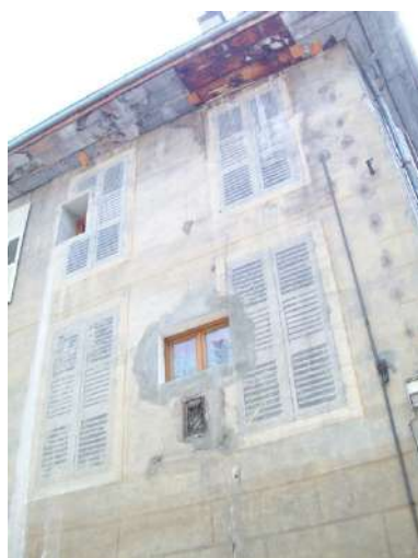
Façade en trompe l'œil (altérée)
