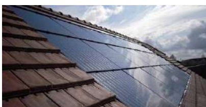
Regroupement des panneaux et intégration dans la couverture, teinte uniforme
