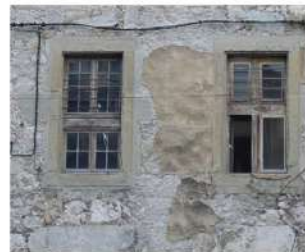
Élément parasite : ventouse de chaudière
