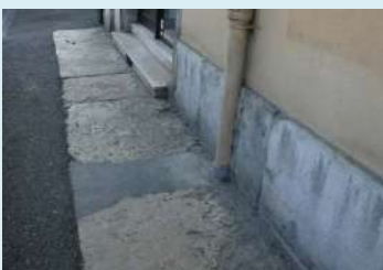
Dalles calcaires – Avenue de Lyon Non jointoyées à l'origine
