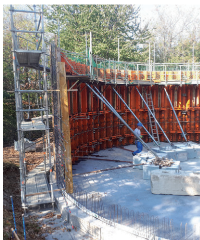
Réalisation d'une seconde cuve de 500 m 3 au réservoir de Challot à Chambéry
