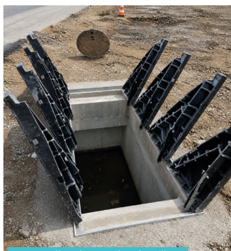
Trappe d'accès au piège à cailloux
