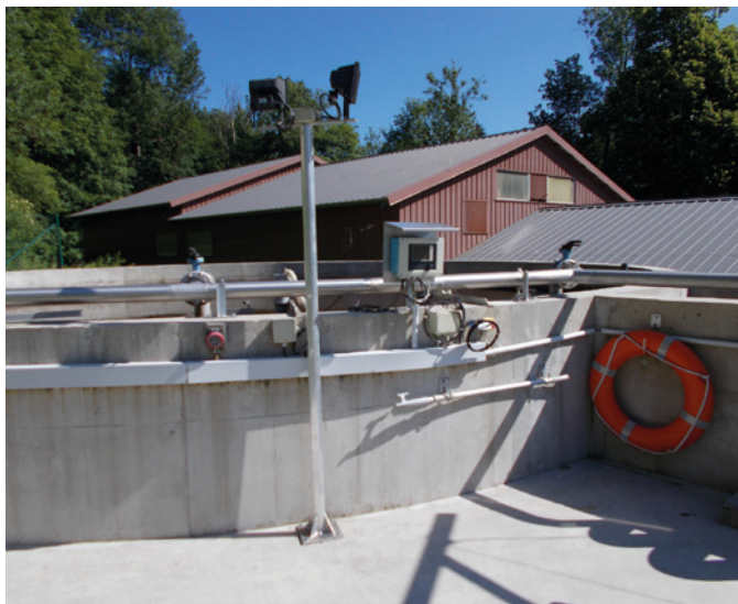
Station d'Épuration d'Aillon-le-Jeune
