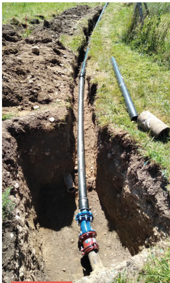
Réseau eau potable
