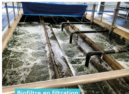
Biofiltre en filtration
