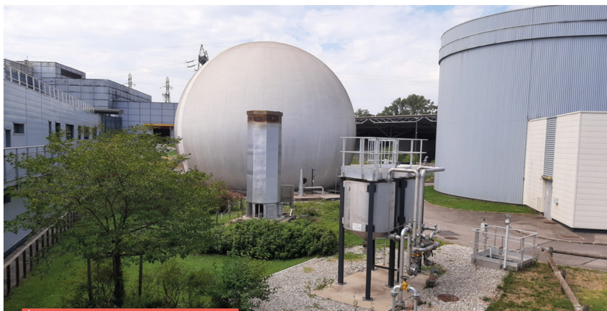
Étape de traitement du biogaz de l'UDEP
