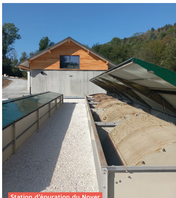
Station d'épuration du Noyer
