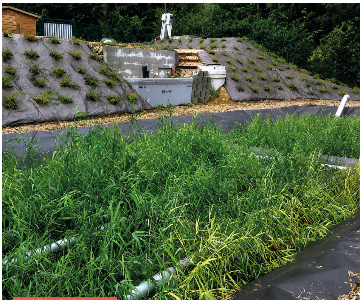
Step à filtres plantés de roseaux
