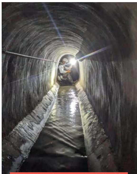
Réseau unitaire du centre ancien de Chambéry
