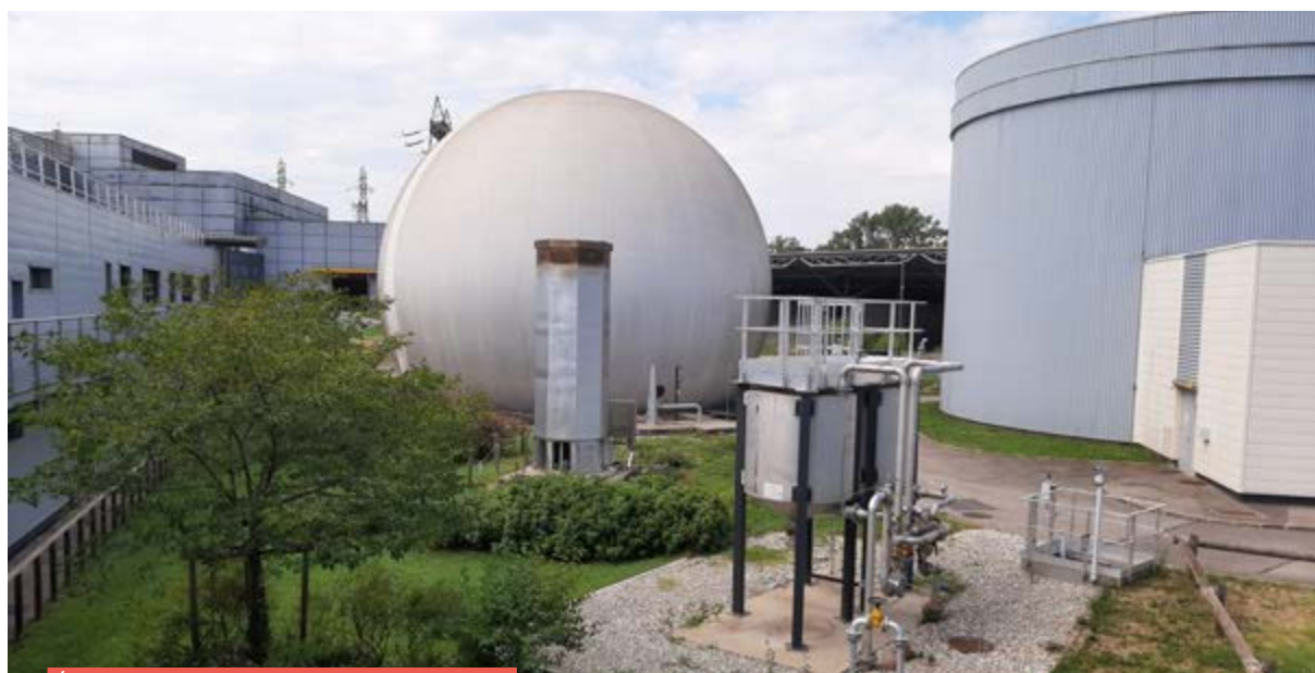
Étape de traitement du biogaz de l'UDEP
