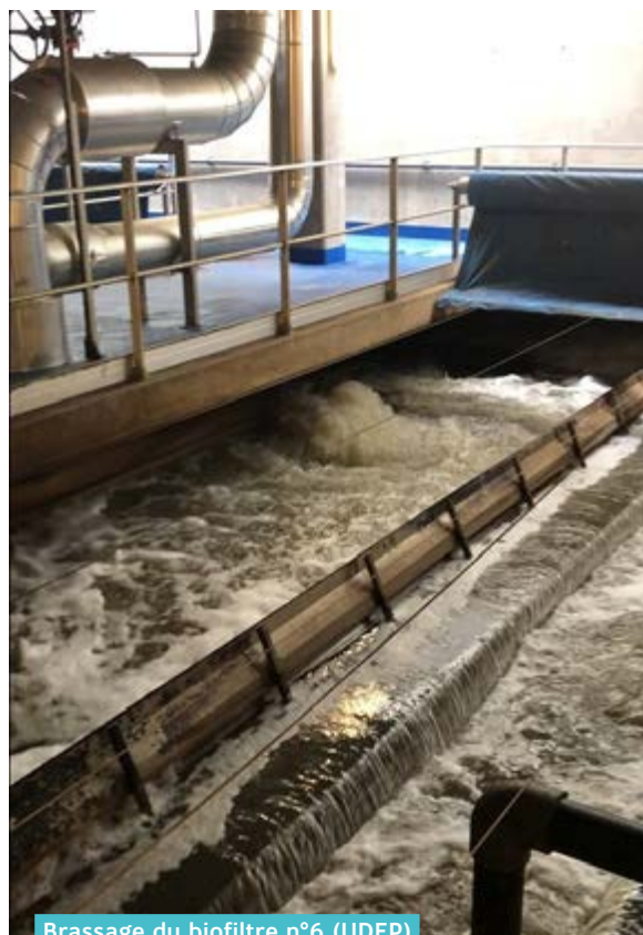
Brassage du biofiltre n°6 (UDEP)
