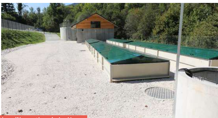
Station d'épuration de Le Noyer
