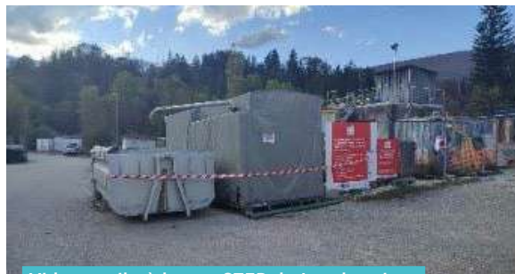
Vidange silo à boues STEP de Lescheraines
