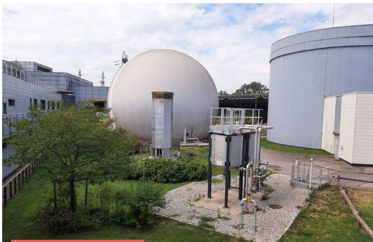
Étape de traitement du biogaz de l'UDEP
