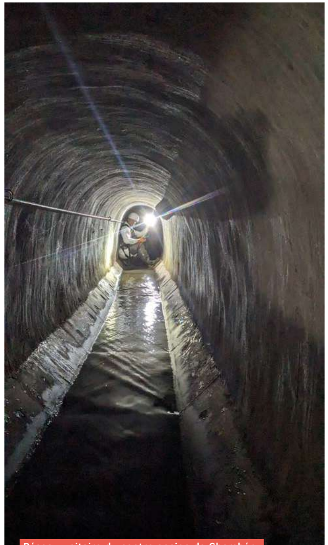
Réseau unitaire du centre ancien de Chambéry
