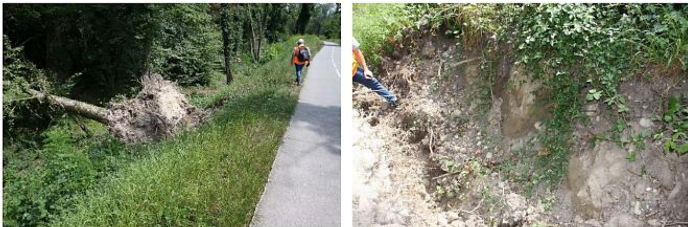
Figure 9 : Arbres déchaussés sur le talus aval de la digue rive droite lors de la tempête de juillet 2019 au PKL4.68 (les arbres ont été débités et évacués depuis et les loupes comblées). Source : AVP CNR
