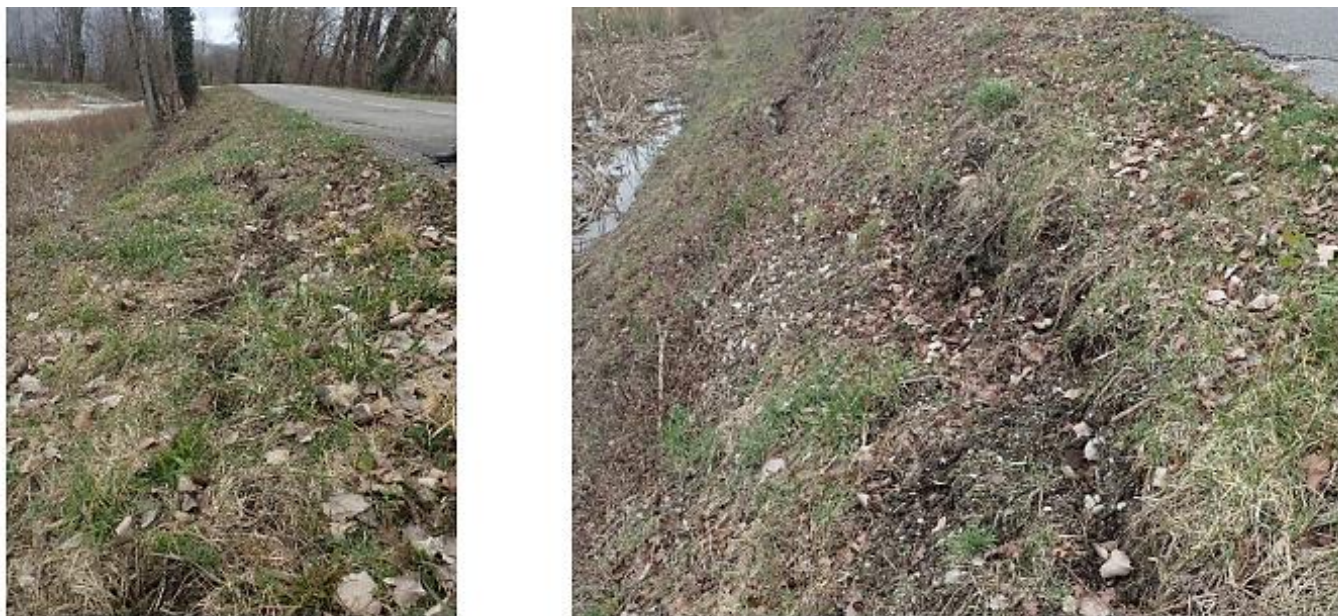
Figure 11 : Fissure sur le talus amont rive droit survenue en février 2020 au point kilométrique 5.85 Source : AVP CNR
