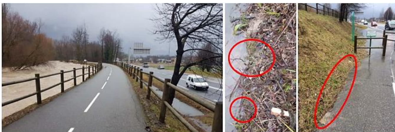
Figure 10 : Vue de la digue rive au droit du coude de Villarcher et venues d'eau (cerclées en rouge) au pied de la digue au pic de la crue du 4 janvier 2018.
