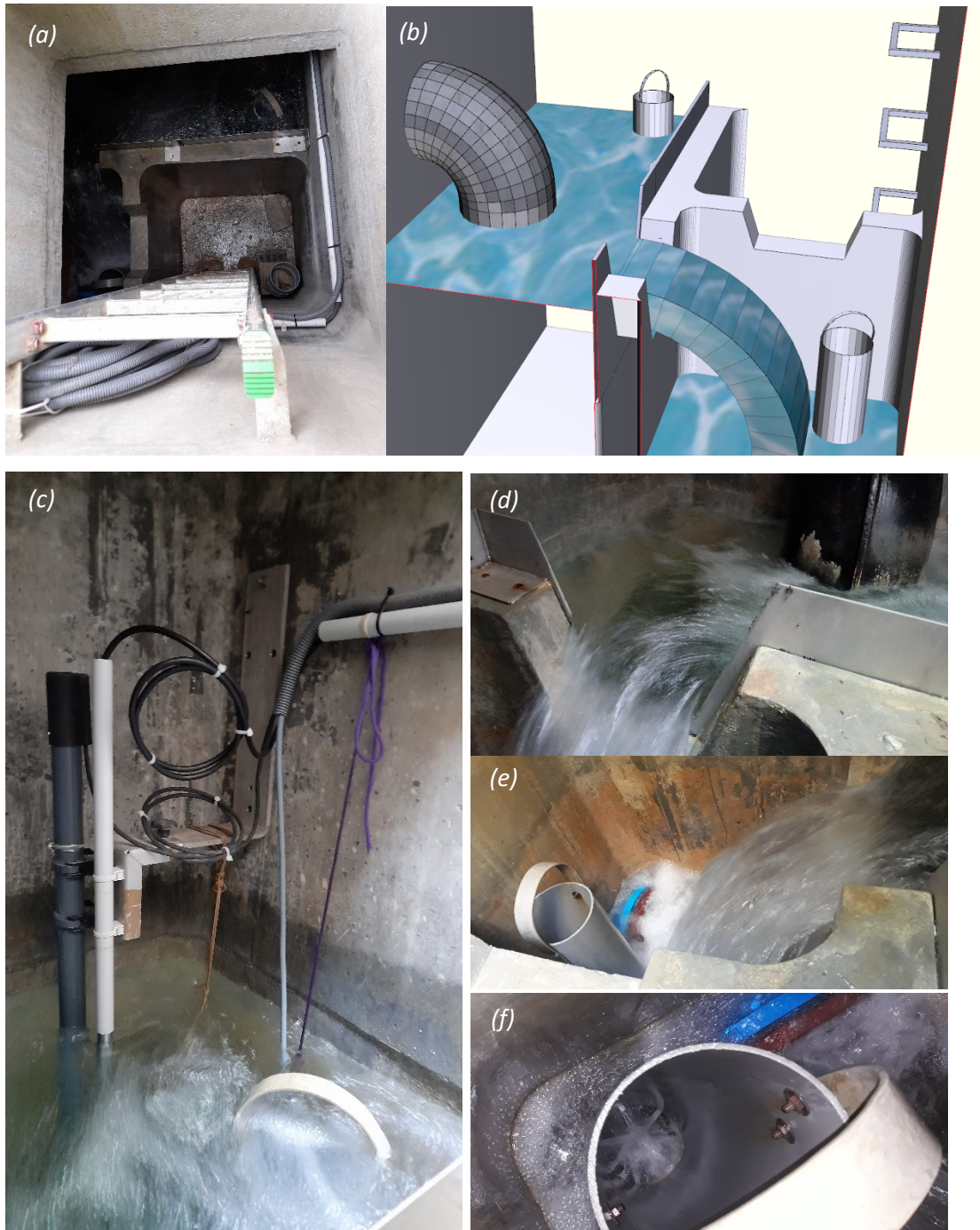
Vue de l'intérieur du captage depuis l'ouverture du tampon foug ; (b) Schéma du captage en fonctionnement avec le seuil trapézoïdal ; (c) Appareils de mesure : sonde par immersion et sonde de conductivité-température, placées dans le bac amont (à côté du 1 er trop plein) ; (d) Seuil trapézoïdal (débit du 01/06/2023 à 15h = 95 m 3 /h) ; (e) Chute du seuil trapézoïdal dans le bac aval ; (f) Trop-plein du bac aval percé à la base.
