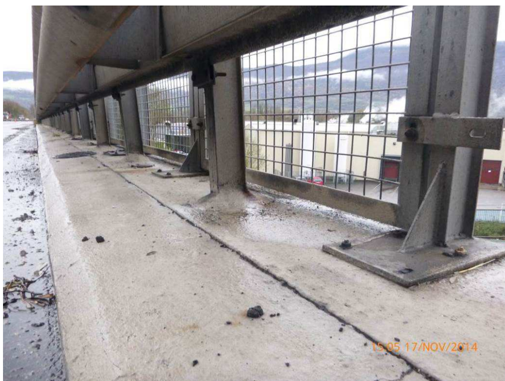
Photo n°6 : Voie nord côté Genève, 1 boulon manquant sur platine de fixation des grilles SNCF
