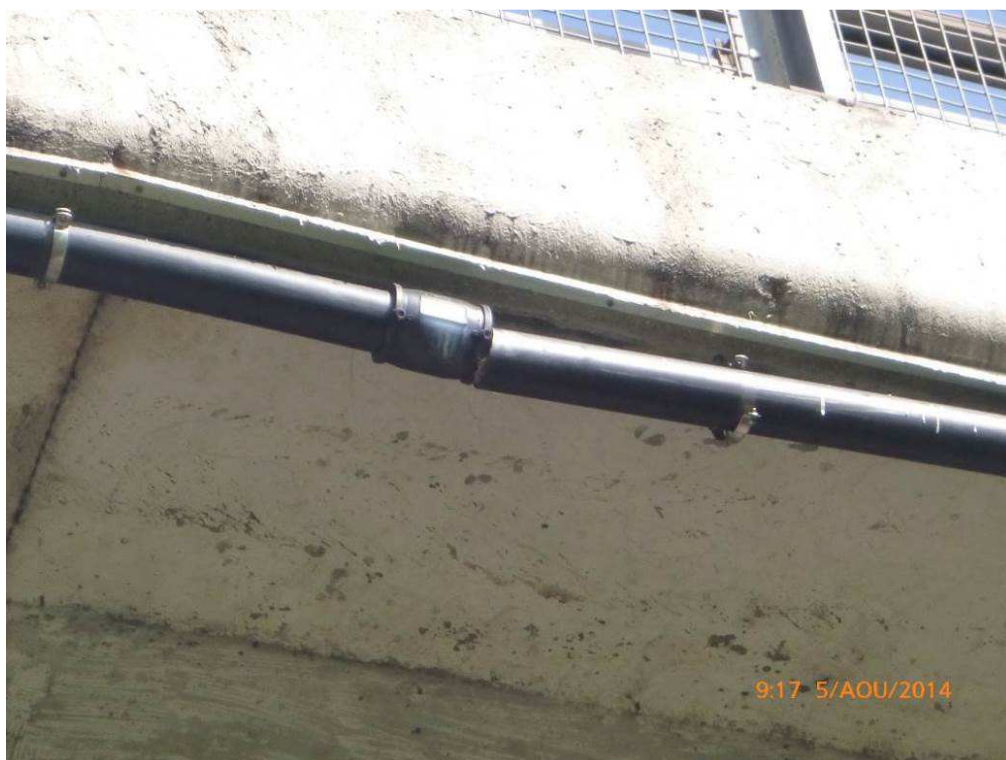
Photo n°15 : Voie sud sur voie SNCF, réseau mal fixé côté Aix-les-Bains
