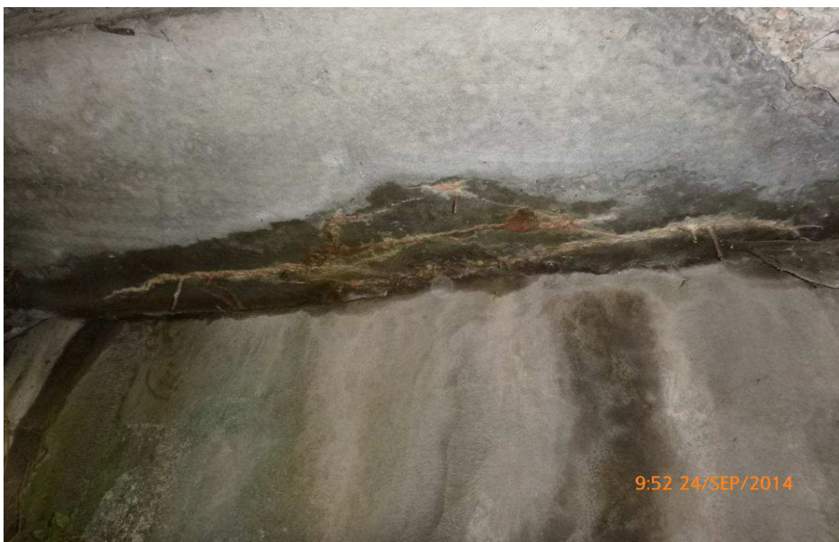
Photo n°28b : Zoom sur 28, culée C0, fissures avec calcite active sur about d'encorbellement
