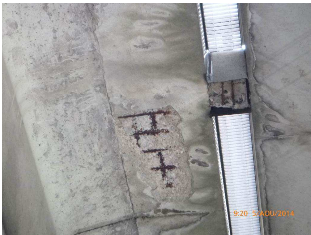
Photo n°19 : Côté SNCF intrados, zone avec aciers apparents oxydés et béton épaufré
