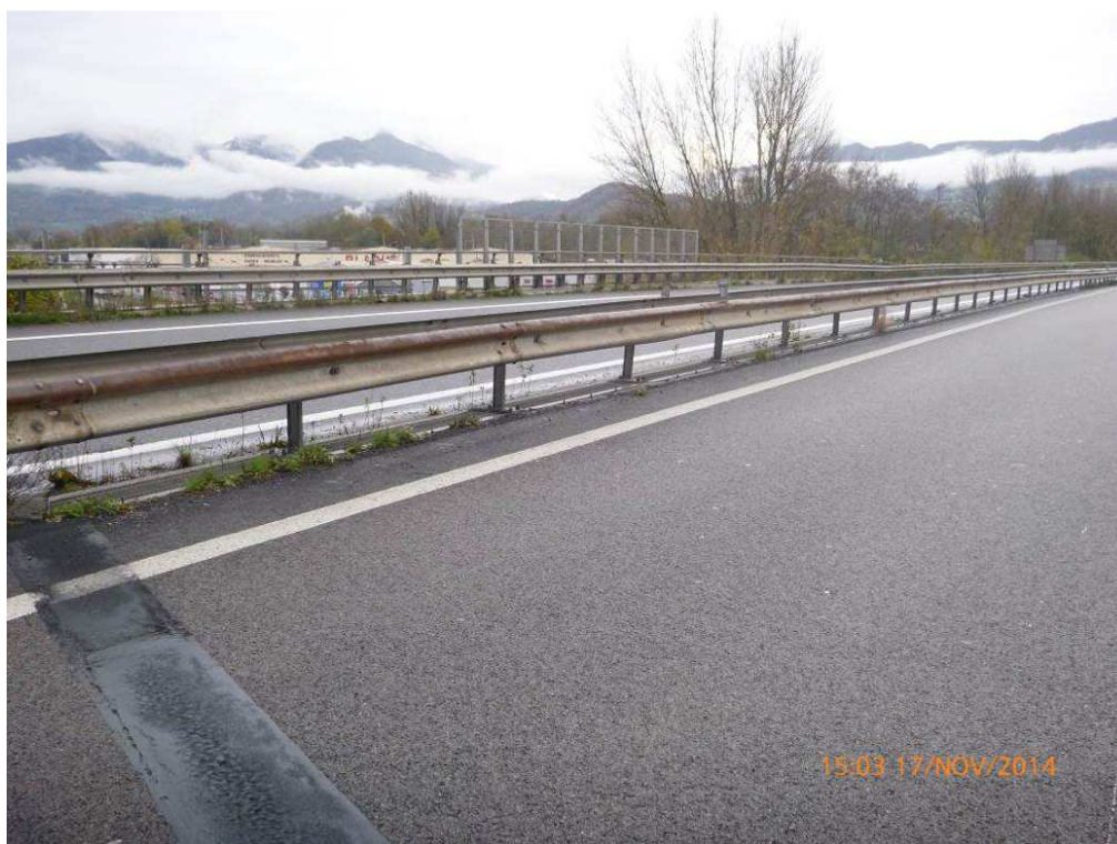
Photo n°3 : Côté Genève sur TPC, oxydation des glissières avec présence de végétation en pied
