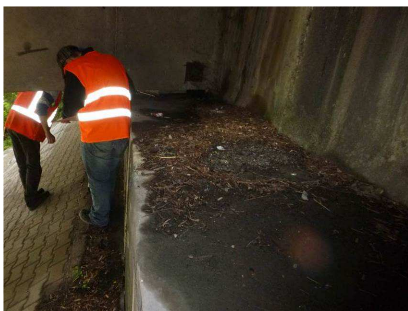
Photo n°31 : Culée C2, dépôt humide sur le sommier
