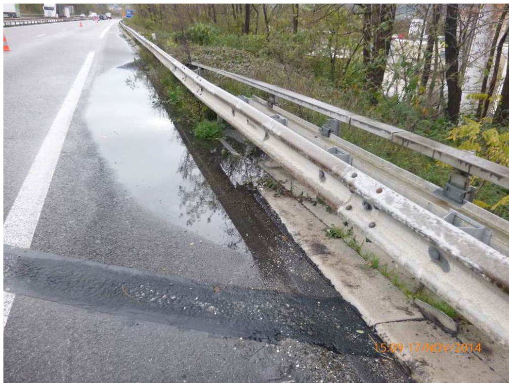
Photo n°11 : Voie nord côté Lyon, stagnation d'eau sur l'accotement
