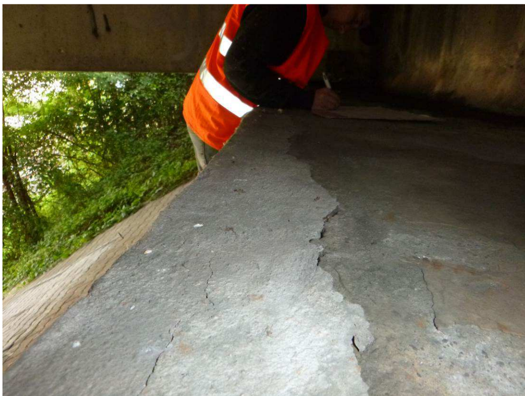
Photo n°37 : Culée C2, ragréage décollé, fracture sur chevêtre
