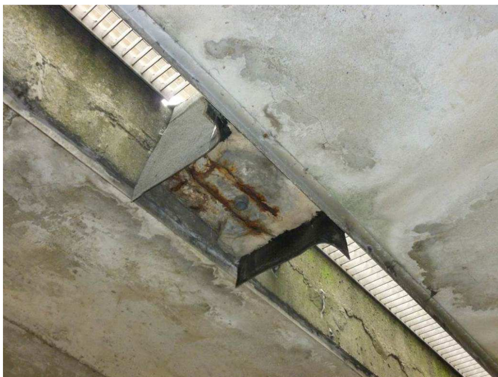
Photo n°23 : Intrados axe de l'ouvrage, aciers apparents oxydés sur les plots de fixation GS
