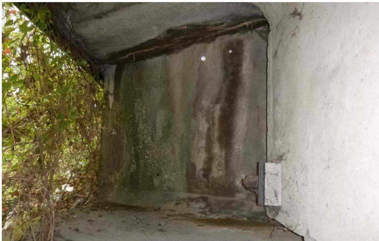
Photo n°28 : Culée C0, fissures avec calcite active sur about d'encorbellement et coulures humide sur le mur garde grève
