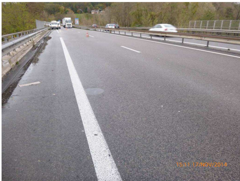
Photo n°12 : Voie nord, vue sur l'enrobé avec une stagnation en rive et ressuage bitume
