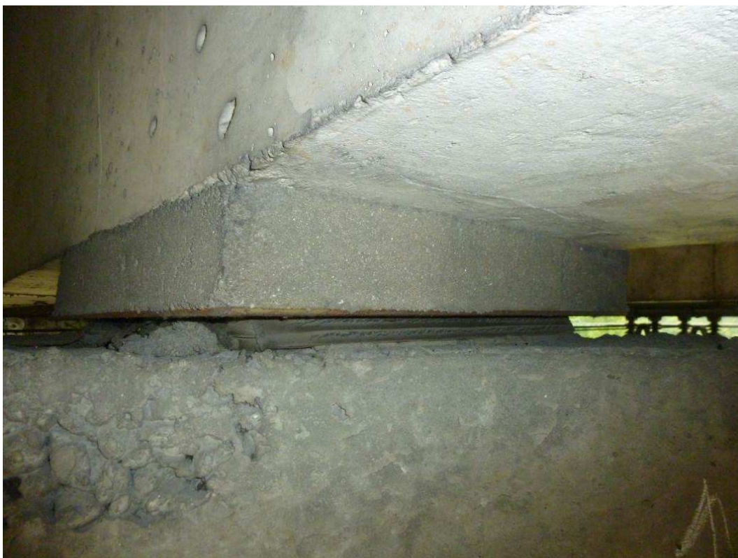
Photo n°36 : Pile P1, distorsion de l'appareil d'appui, boudiné et craquelé
