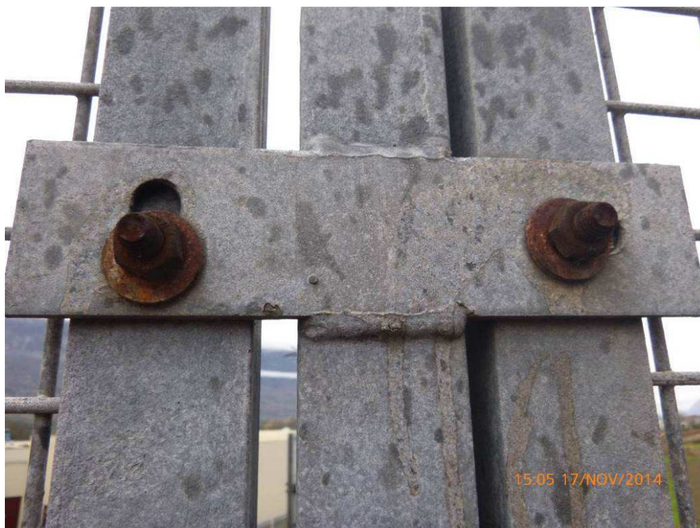
Photo n°7 : Voie nord côté Genève, boulons oxydés sur les fixations des grilles SNCF
