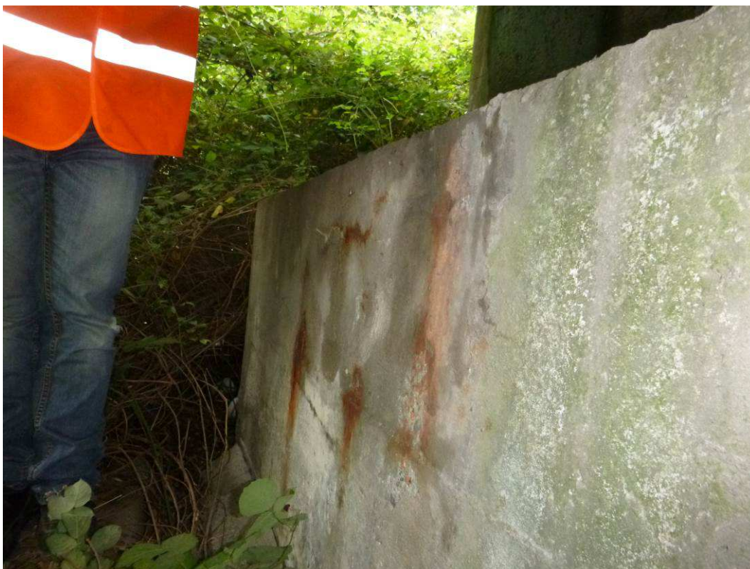
Photo n°38 : Culée C0 côté Sud, traces de rouille sur agrégé
