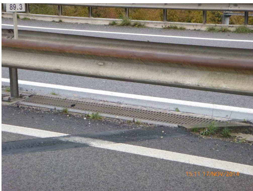
Photo n°4 : Côté Lyon sur TPC, caillebotis déversé
