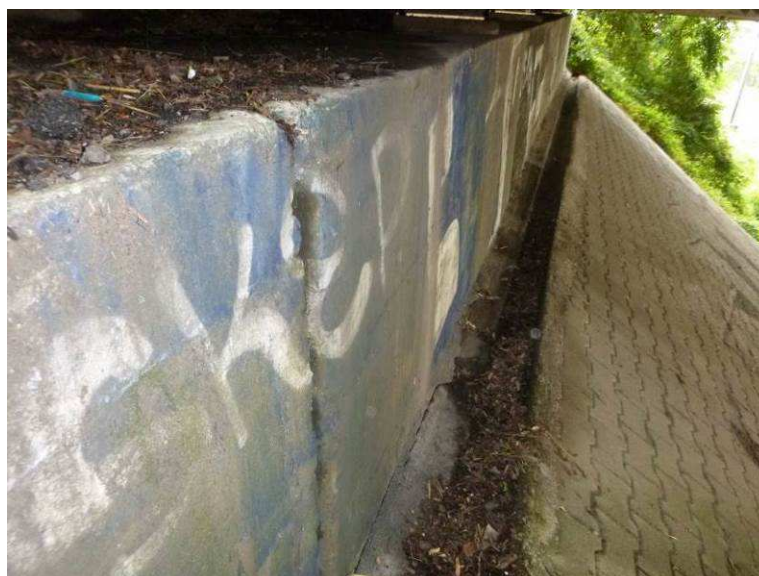
Photo n°33 : Culée C2, cunette fracturée et encombrée
