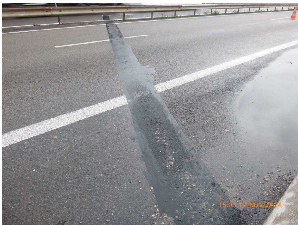
Photo n°8 : Voie nord côté Lyon, reprises sur joint souple avec une zone d'altération en BAU
