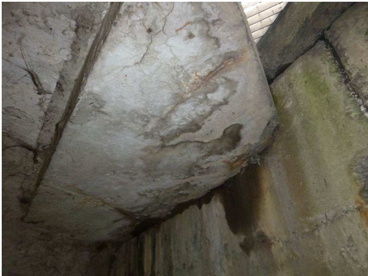
Photo n°32 : Culée C2, entretoise d'about avec fissures, aciers apparents, traces de ruissellement et humidité. Arrivée d'eau contre mur garde-grève
