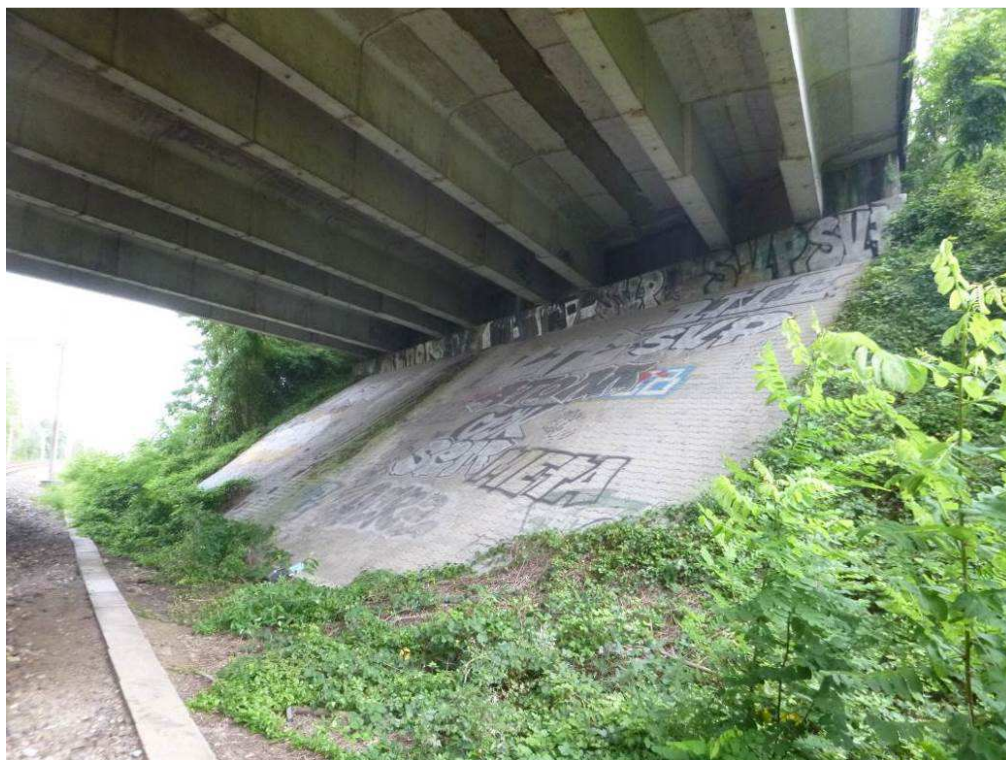
Photo n°25 : Culée C2, végétation sur le perré
