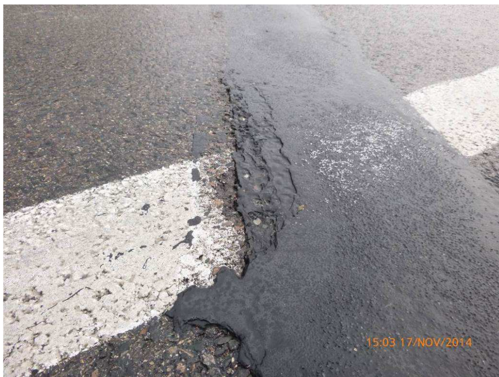
Photo n°10 : Voie nord côté Genève, vue sur la zone décollée
