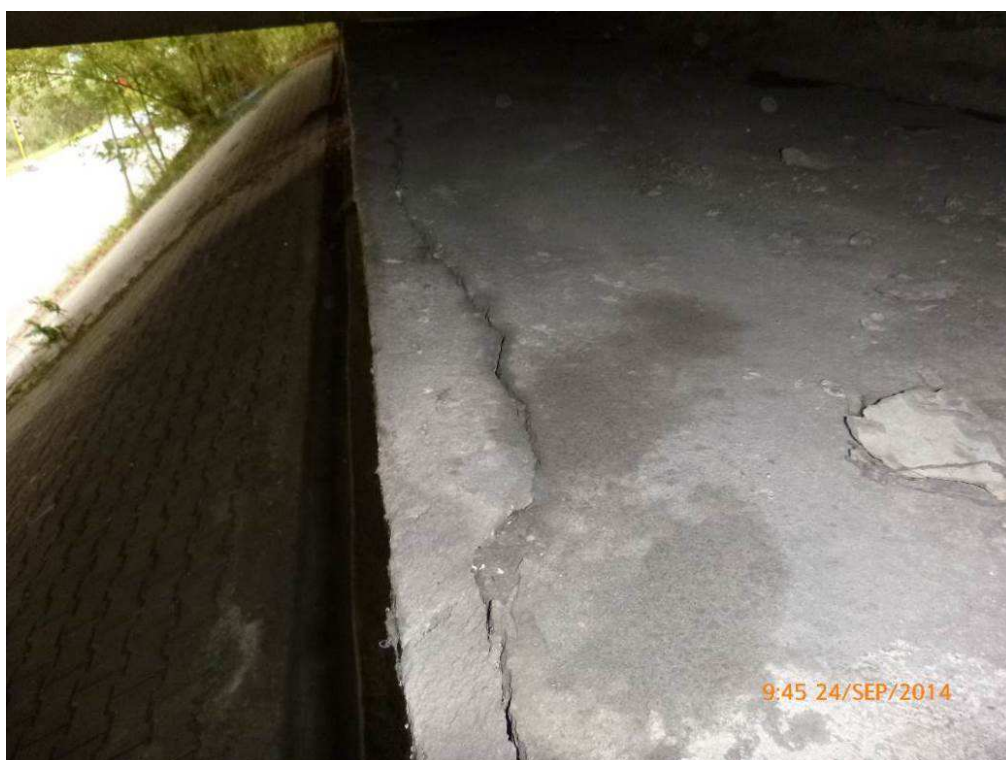
Photo n°26 : Culée C0, fracture sur le sommier
