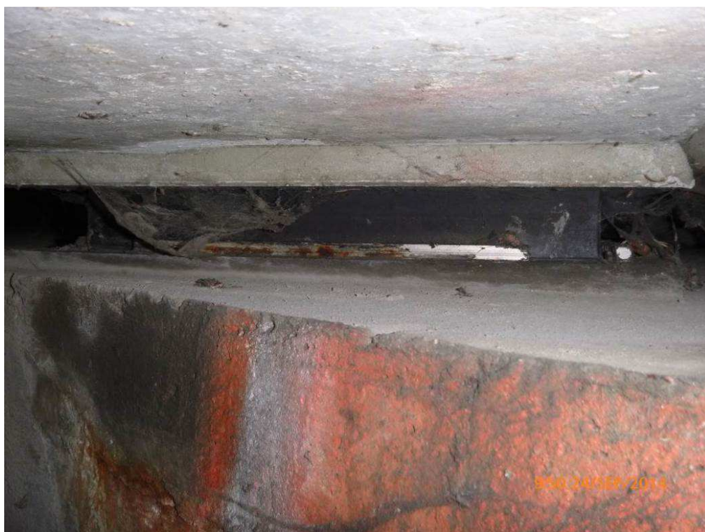
Photo n°34 : Culée C0, oxydation du dispositif anti-glissement de l'appuis
