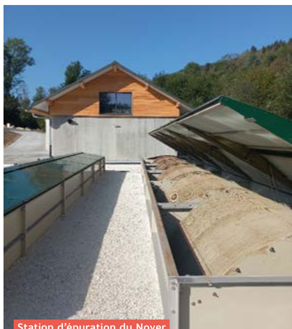
Station d'épuration du Noyer
