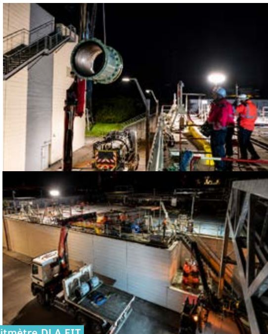
Remplacement du débitmètre DLA FIT
