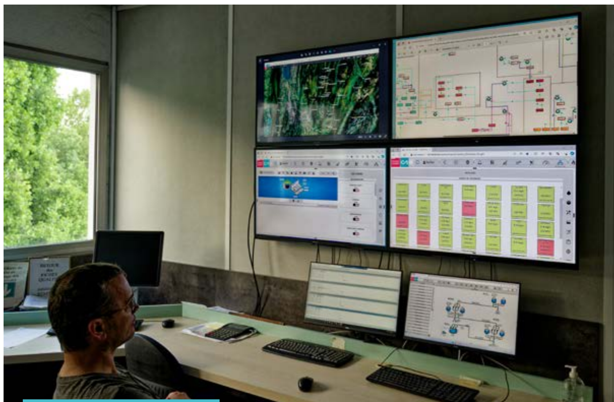
Supervision du niveau d'eau potable
