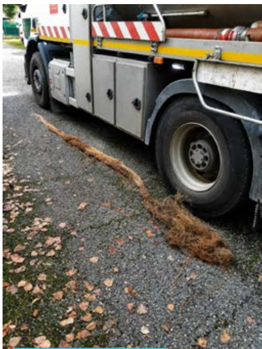
Racine enlevée des réseaux
