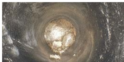
Chambéry – Allée du Poitou Affaissement lié à la présence de rats ayant dégradé le branchement
