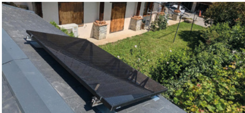
Un kit d'auto-consommation photovoltaïque installé sur un toit
