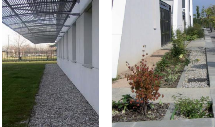
Tranchée d'infiltration avec aménagements de surface
