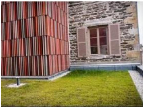
Toiture végétalisée (source : Grand Lyon)
