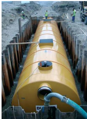
Figure 5 : Décanteur dépollueur mis en place à Strasbourg (débit 490 l/s) (source : Dunex)
